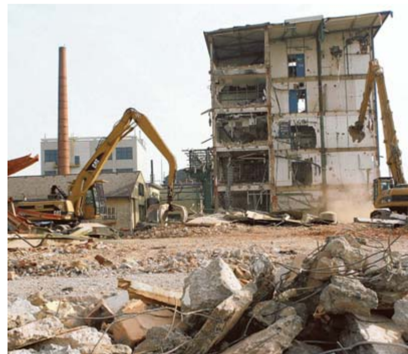
Ende einer Ära: Bagger reißen die Chemiefabrik Great Lakes entlang der Reichenaustraße ab. Ende des Jahres soll die Fläche frei sein. BILD: HANSER
